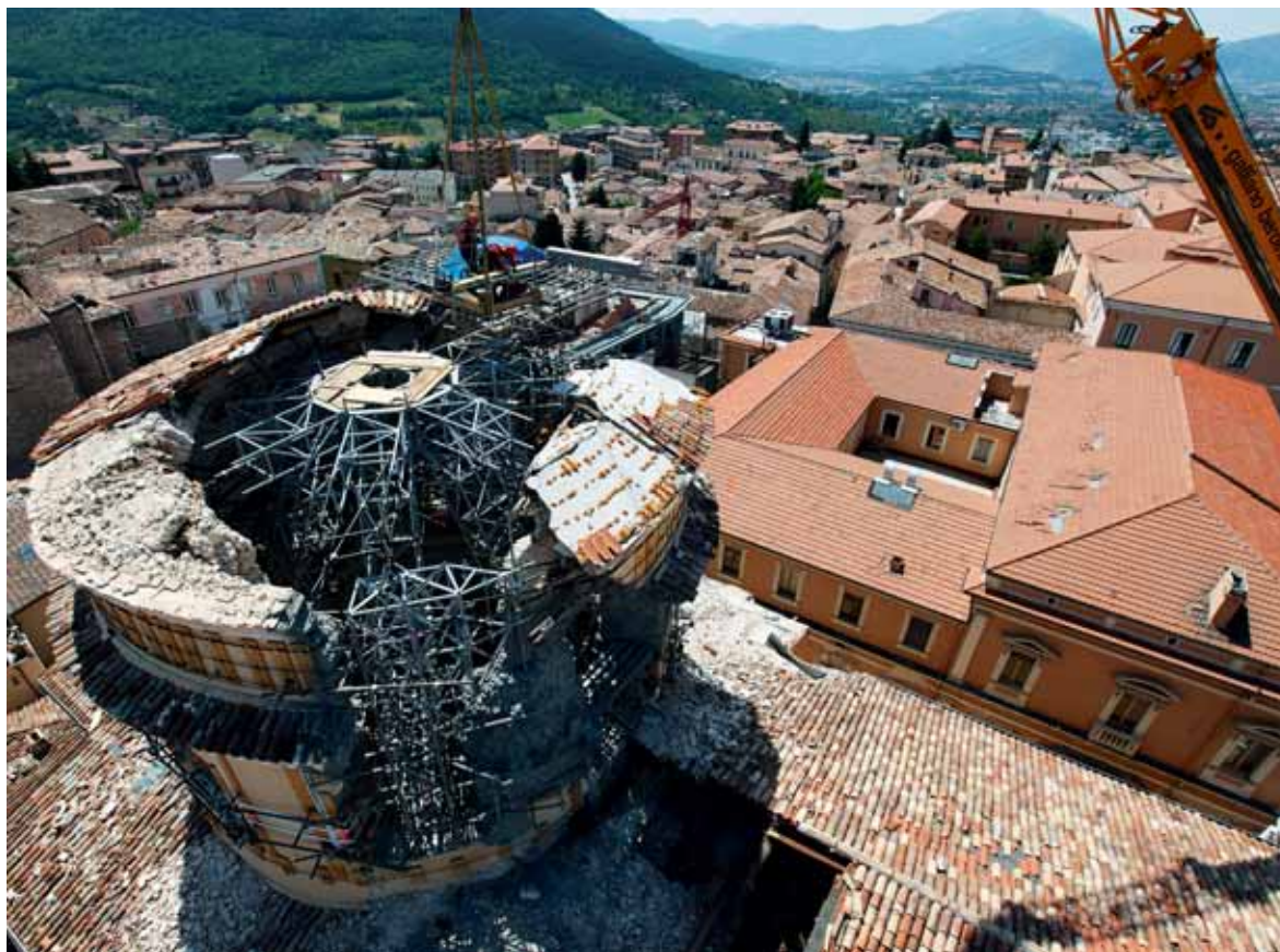
Fig. 9. L'Aquila, église Santa Maria del Suffragio dite delle Anime Sante , mise en sécurité de la coupole écroulée.
